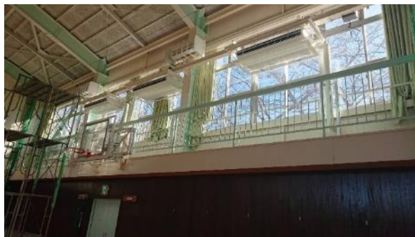
体育館空調設備
