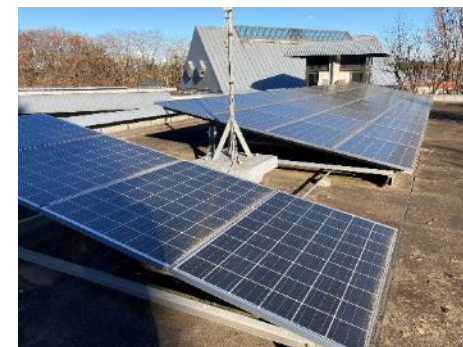
北守谷公民館の太陽光パネル
